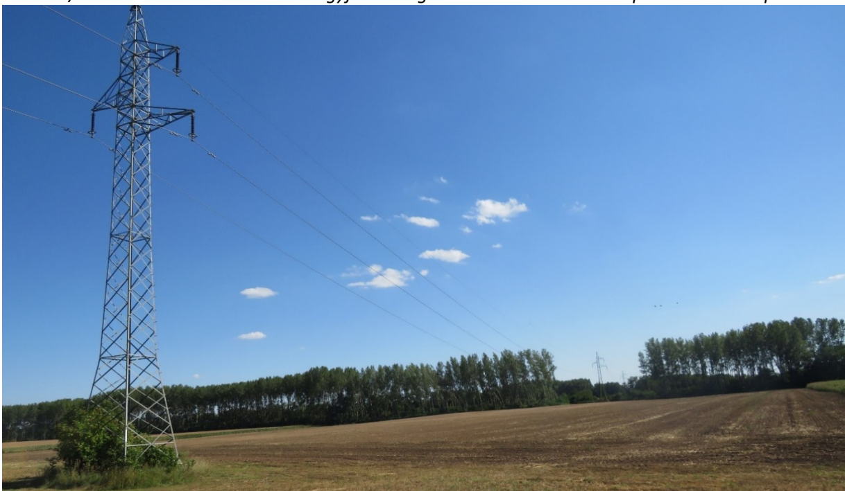
A 0194/16 hrsz.-ú telket keresztező 132 kV-os nagyfeszültségű elektromos távvezeték DK-i irányban
